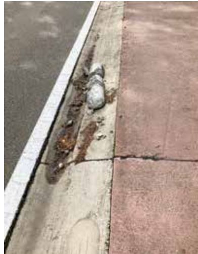
De varkensruggen van de Lindekensbaan zijn stuk en verschoven
