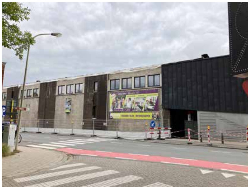
Een deel van het dak stortte in door betonrot
